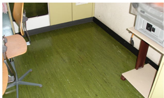
2 Auch bei diesen elastischen Bodenbelagsbahnen ist der Asbest im Kunststoff festgebunden.
